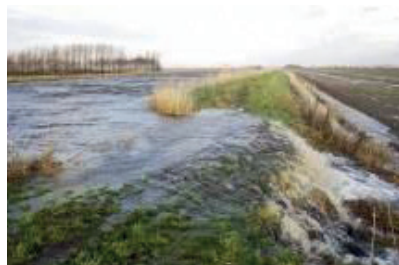
Abb. 41: Drohender Deichbruch durch Überströmen
